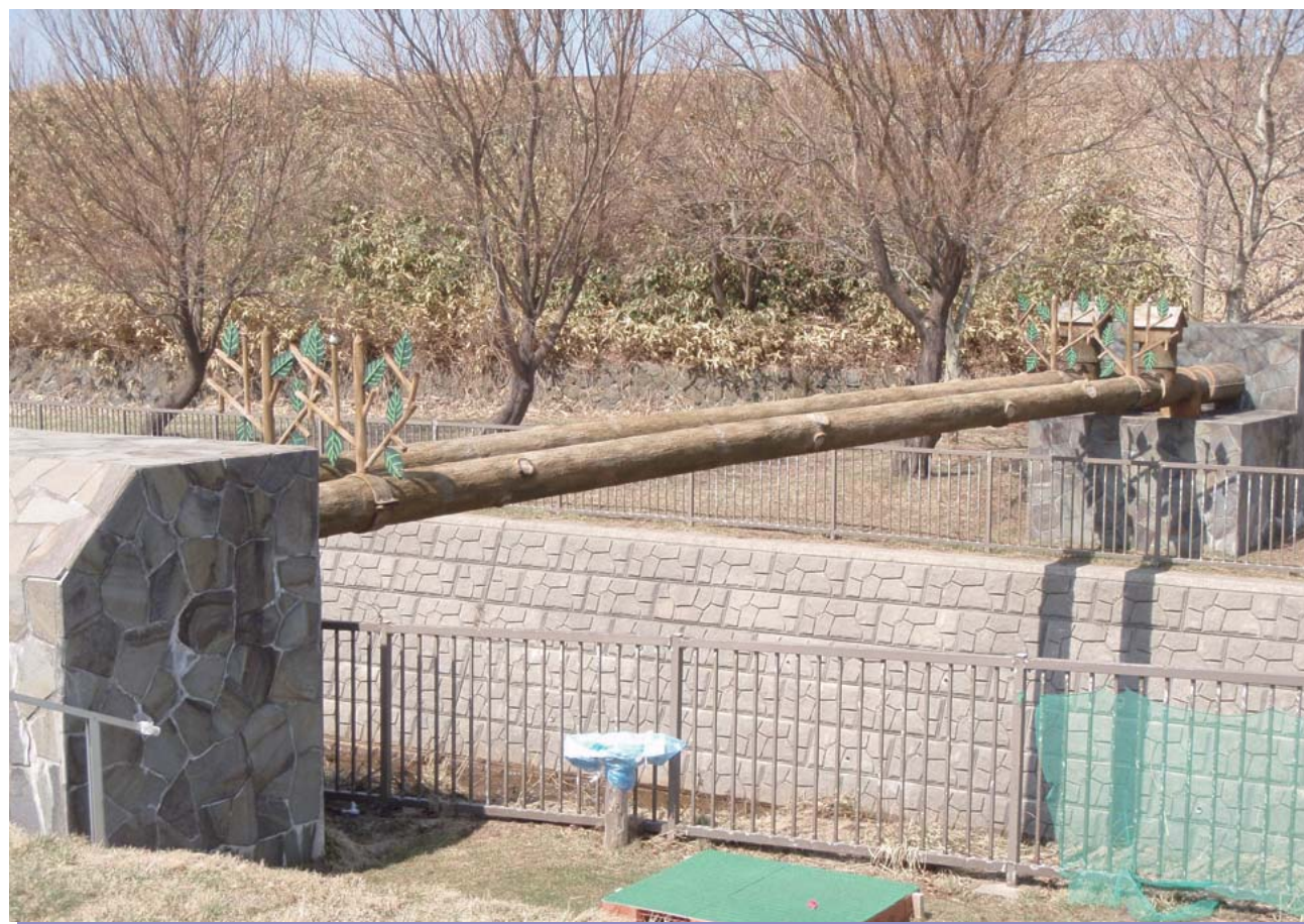
FRP 擬木仕様の水管橋で公園内の景観を損なわない工夫をしています。
