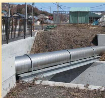
北海道胆振管内 鉾山排水水管橋 400A / \phi 500 L=6.6m
