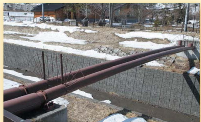
北海道胆振管内 なかよし橋水管橋 右側 250A / 400A L=31.31m 左側 300A / 400A L=31.31m
