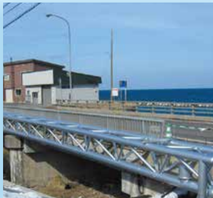
北海道渡島管内 常路川水管橋 80A / 200A L=38.4m
