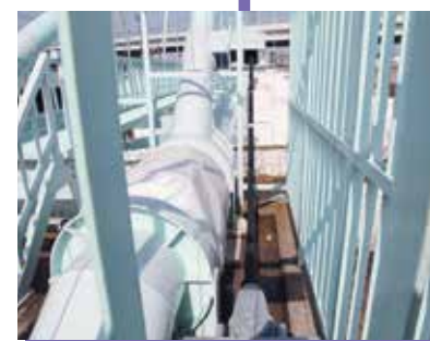
ケーブル等で水管橋が落ちるのを防ぎます。
