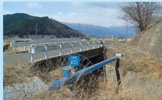
長野県 第一田川橋水管橋 250A / 350A L=17.0m
