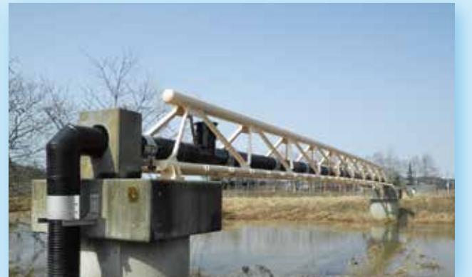
北海道厚岸郡厚岸町 第3尾幌水管橋 200A / 350A L=38.1m
