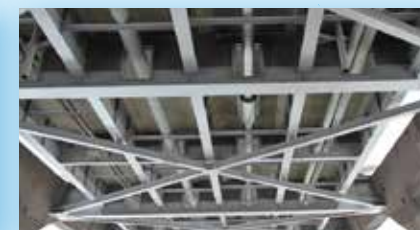
北海道石狩管内 ポンノッポ口橋 200A / \phi 300 L=115.65m
