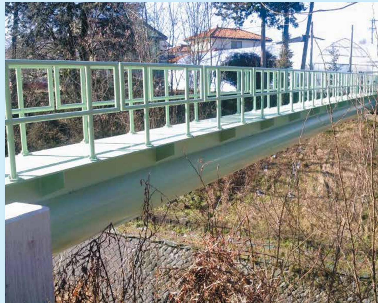
長野県 飯田 2 号橋 700A(鋼管) L=33.3m
