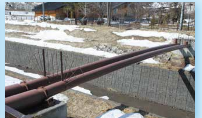
北海道胆振管内 なかよし橋水管橋 右側 250A / 400A L=31.31m 左側 300A / 400A L=31.31m
