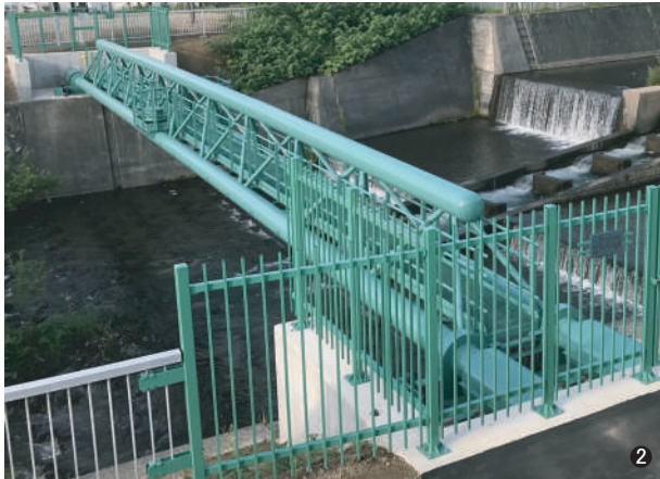
②三角形トラス型水管橋（北海道）
