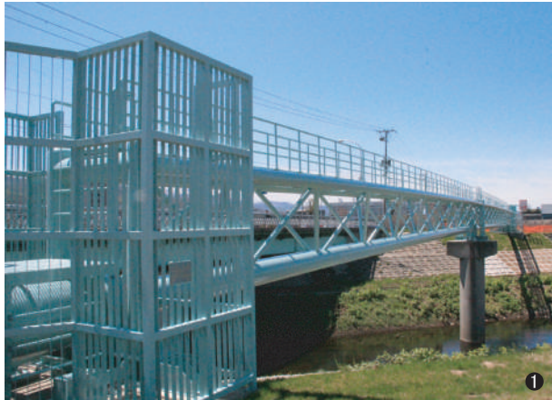
①逆三角形トラス型水管橋（北海道）
